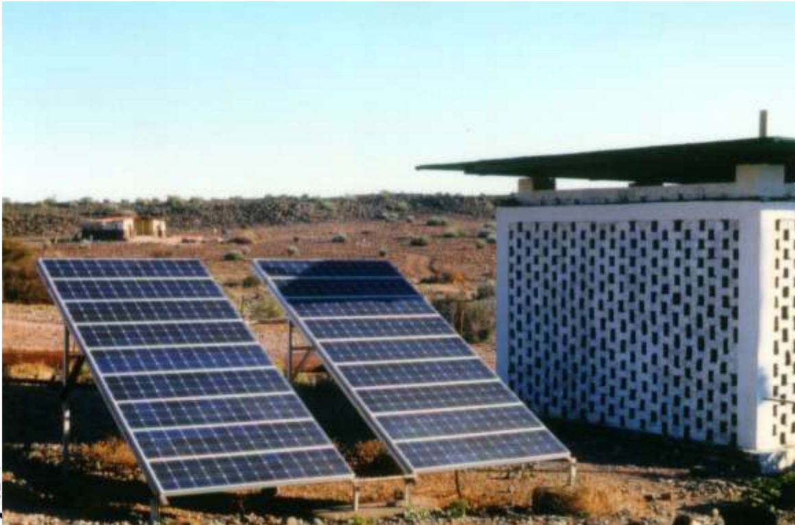
Traditioneller Farmkühler und moderne Solarpanelen zur Stromerzeugung. - Solarkraft zur Abdeckung technischer Energienischen. (Betriebshof Soutkuil im CNP, 1998)
